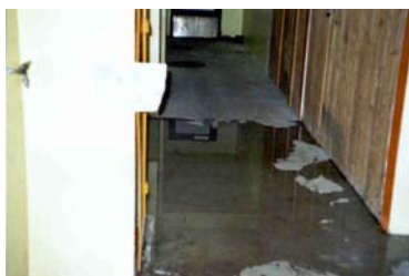
Oversvømmelse i kælder
