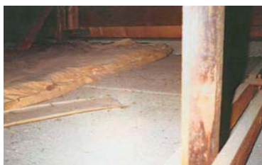
Manglende isolering i tagrum
