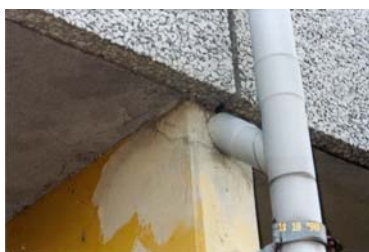
Betonskade ved altanramme
